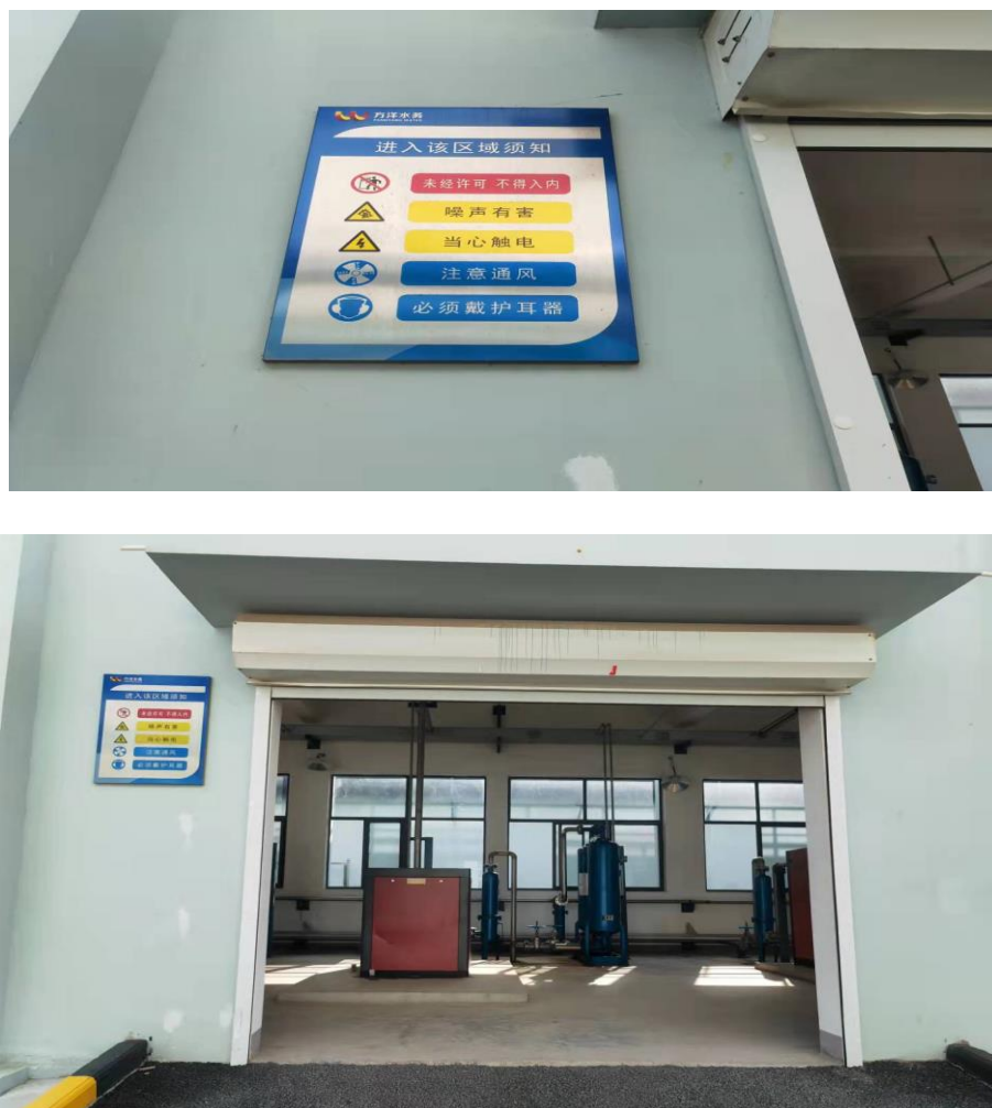
图 4.1.3-1 空压机房等现场噪声标识
