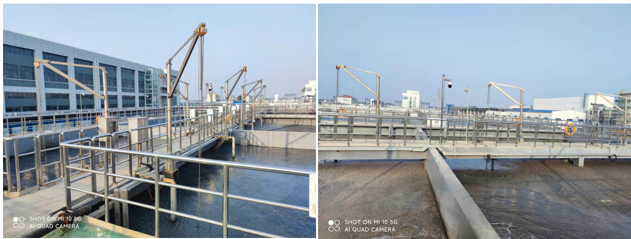
图 4.1.1-4 尾水及循环水生化组合池
