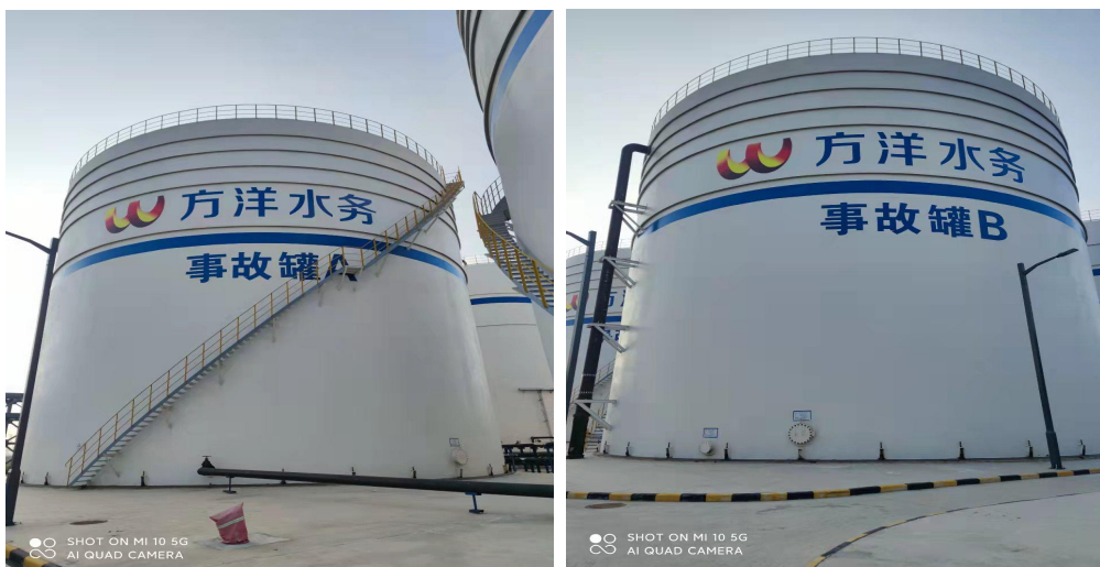
图 4.1.1-1 尾水及循环水序列调节罐和事故罐
