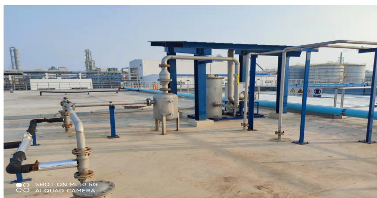
图 4.1.2-1 臭氧接触池加盖、臭氧尾气破坏装置
