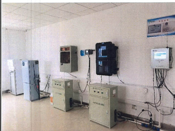
废水进出水在线监测设施
